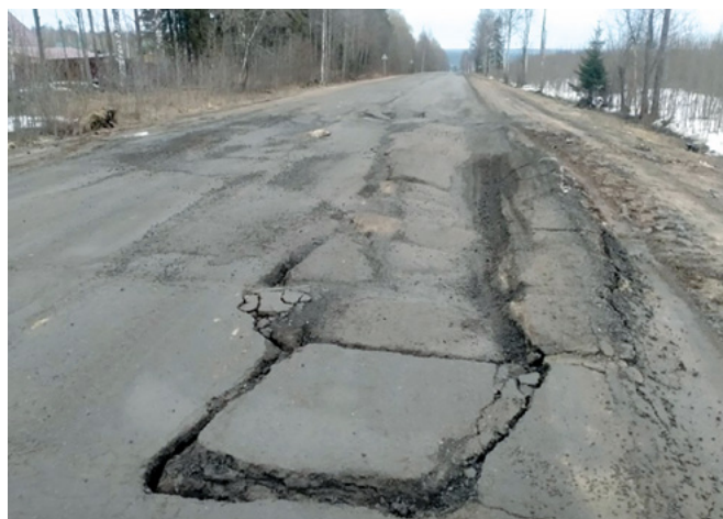
Участок дороги до ремонта
