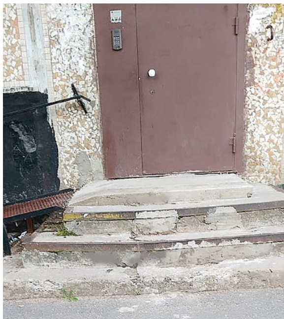
Пандус с наращенной площадкой крыльца
