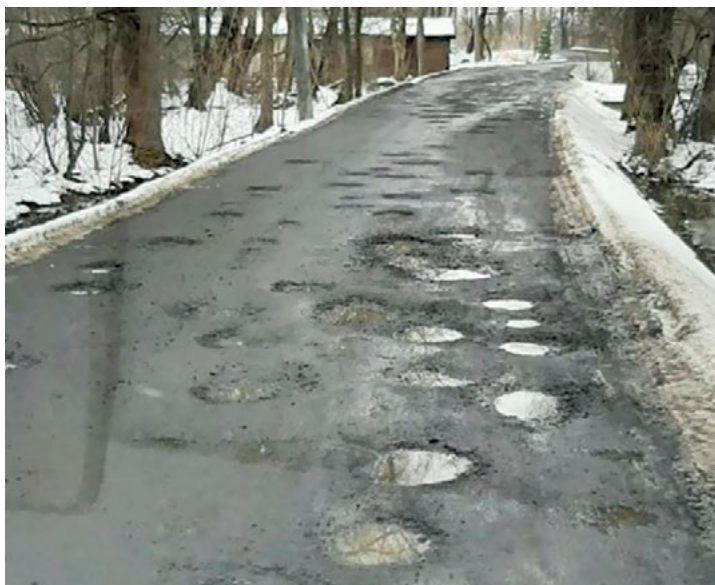
Разбитая дорога к Ломоносовскому ИВС до ремонта
