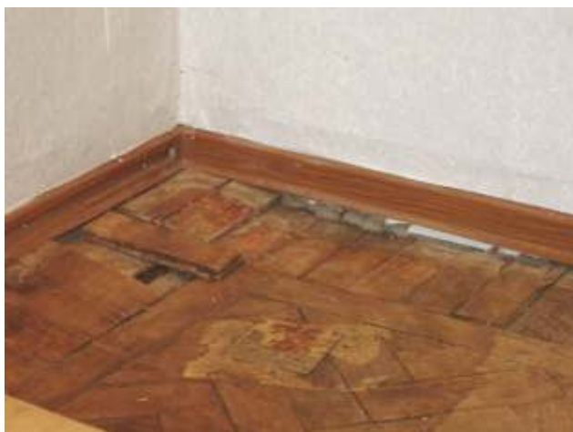
Пол в «новой» квартире до ремонта
